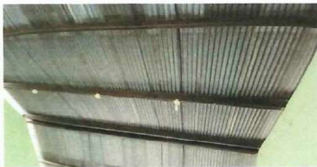
Foto 2: ESTRUCTURA DE TECHO: falta de mantenimiento de las estructuras metálicas de aulas, dirección y bodega.
