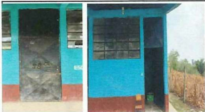
Foto 3: PUERTAS DE METAL: Falta de mantenimiento en pintura de las puertas de aulas, dirección y bodega.
